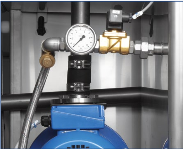
Manometer zur Druckprüfung – einfache Funktionskontrolle
