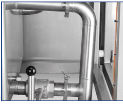
Bild.16 Demontierbare Verrohrung – optimale Zugänglichkeit
