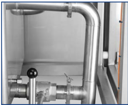
Bild.16 Demontierbare Verrohrung - optimale Zugänglichkeit
